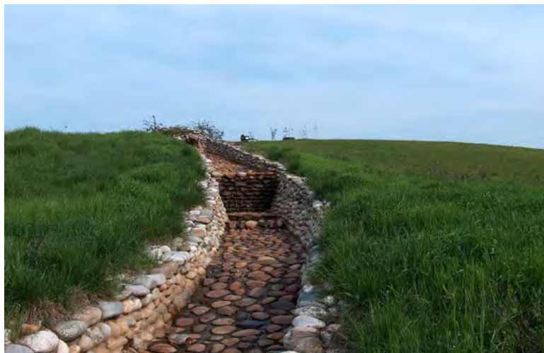
Fig. 12: Discarica di Cavenago-canalina di raccolta per acque meteoriche
